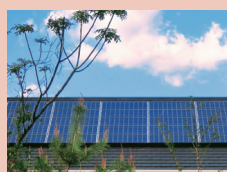
太陽光パネル
