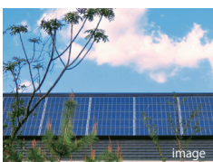
太陽光パネル
